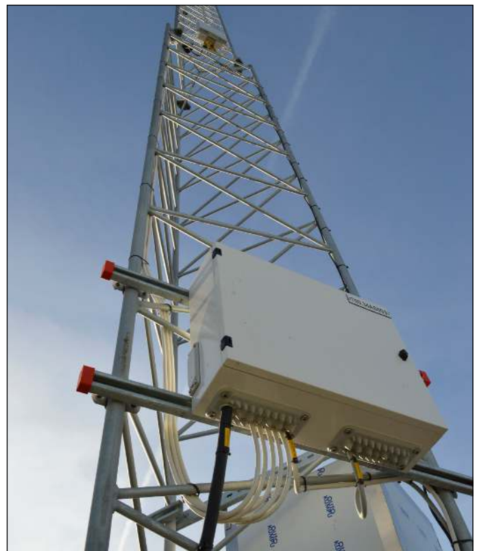
Enklare kapsling istället för stora, dyra drivdonskåp.
