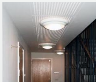
Ovan: Ledina installerad i trapphus
